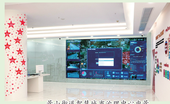
景山街道智慧城市治理中心内景
