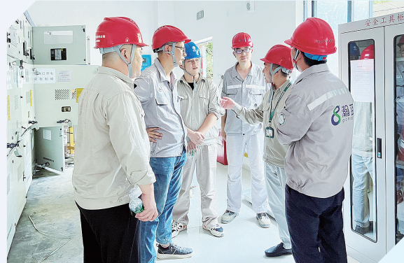
垃圾焚烧发电厂新建配电工程送电成功
