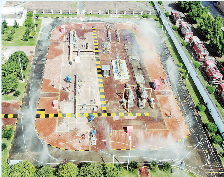
消防救援人员对厂区内泄露天然气进行全面稀释
