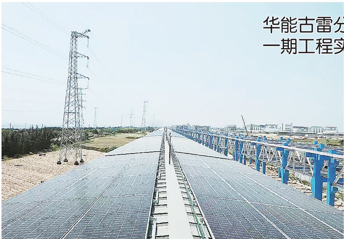
电力管廊光伏项目实现并网发电
